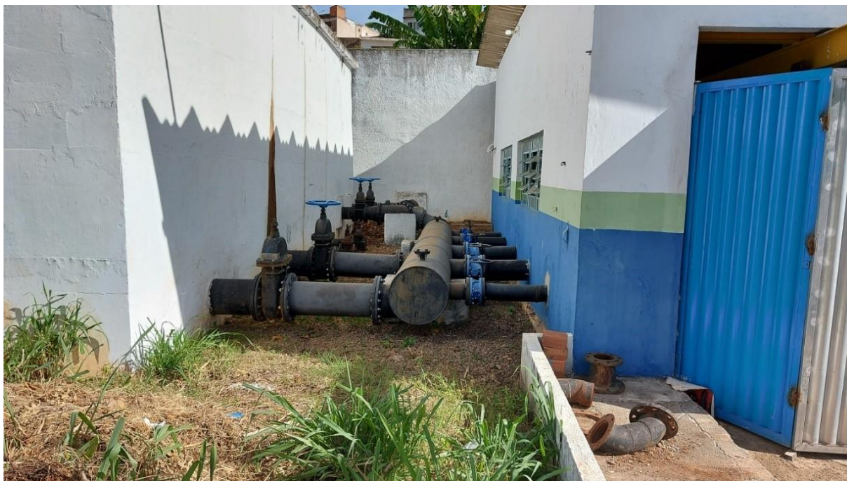
Figura 21 – Estação Elevatória de Água Tratada EEAT, CASAL Fonte: Instituto Gesois, 2020.
