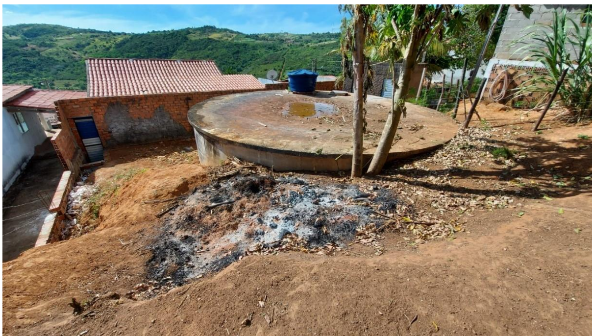
Figura 20 – Reservatório de Água Tratada CASAL Fonte: Instituto Gesois, 2020.
