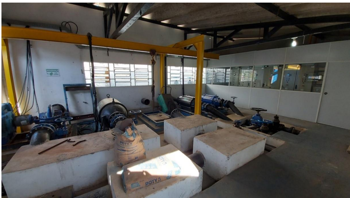
Figura 22 – Estação Elevatória de Água Tratada EEAT, CASAL Fonte: Instituto Gesois, 2020.
